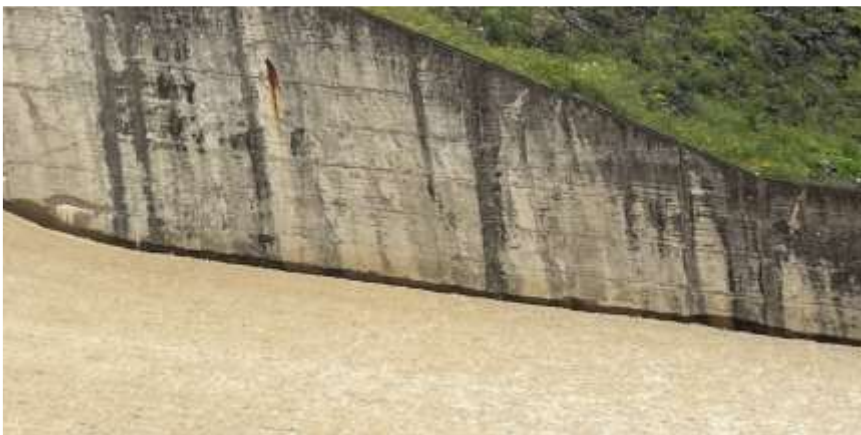
Foto N.º 37: Jusante da barragem - Margem Direita Muro do vertedouro – ponto com princípio de processo corrosivo
