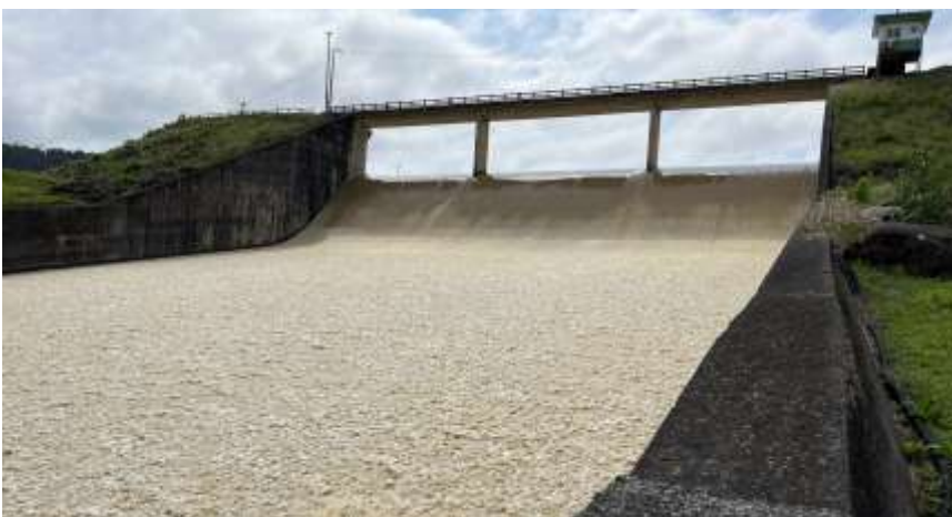
Foto N.º 20: Margem Esquerda - Jusante da barragem Sistema de vertedouro de soleira livre
