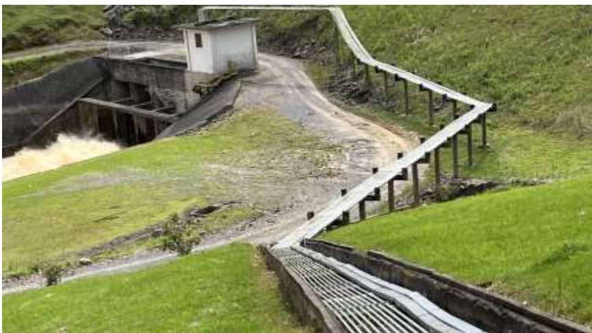
Foto N.º 05: Margem Esquerda - Jusante da barragem Sistema de tubulação de acionamento hidráulico Operação das comportas
