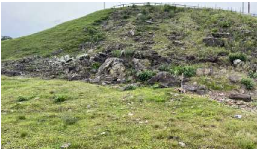
Foto N.º 35: Jusante da barragem - Margem Direita Talude de grama na ombreira direita e encontro com enrocamento
