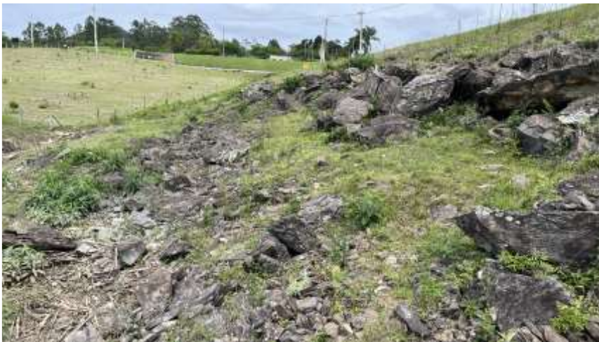
Foto N.º 27: Montante da barragem - Margem Esquerda Vista do talude de enrocamento na direção da ombreira esquerda
