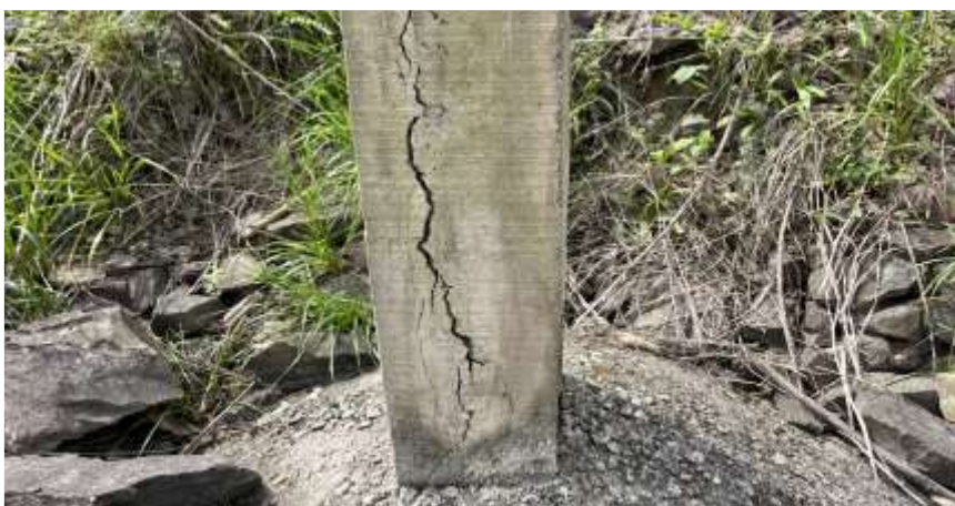
Foto N.º 14: Margem Esquerda - Jusante da barragem Pilares de concreto, apoio da tubulação - processo corrosivo (Expansão/deslocamento)
