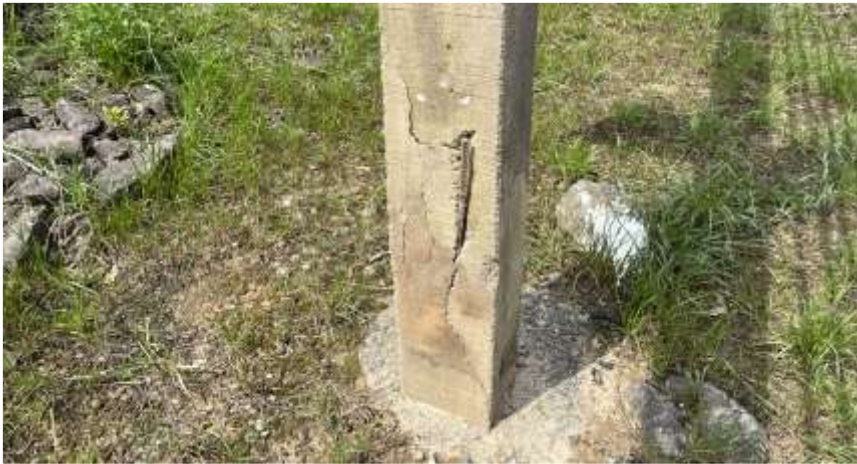
Foto N.º 15: Margem Esquerda - Jusante da barragem Pilares de concreto para apoio da tubulação – processo corrosivo Concreto armado com armadura exposta
