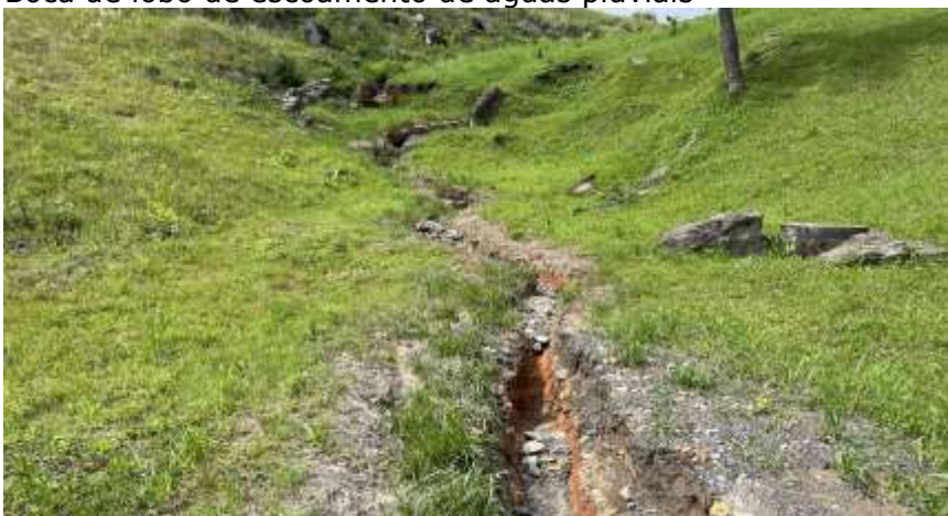
Foto N.º 10: Margem Esquerda - Jusante da barragem Valeta de escoamento de águas pluviais - Pequeno processo erosivo
