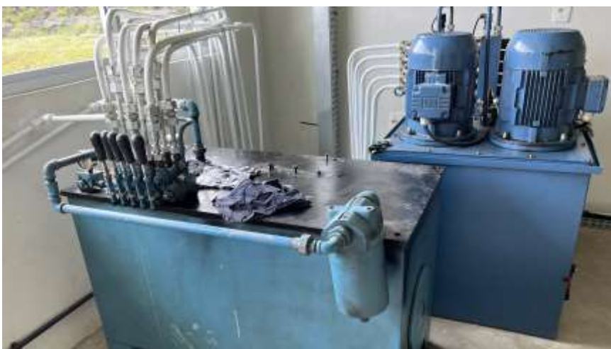
Foto N.º 02: Sala de Operação Equipamentos em condição operativa
