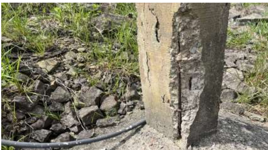
Foto N.º 13: Margem Esquerda - Jusante da barragem Pilares de concreto para apoio da tubulação - Armadura exposta
