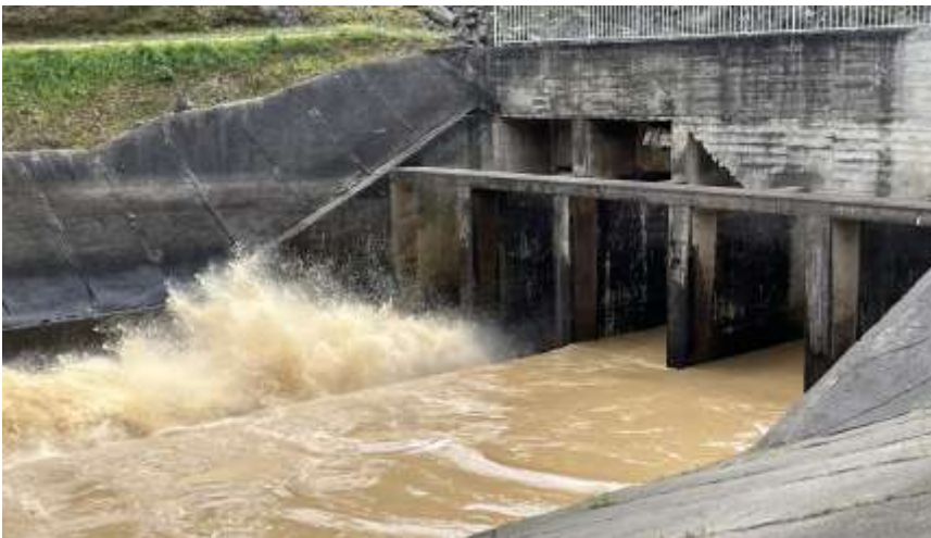
Foto N.º 19: Margem Esquerda - Jusante da barragem Sistema de comportas hidráulicas em operação
