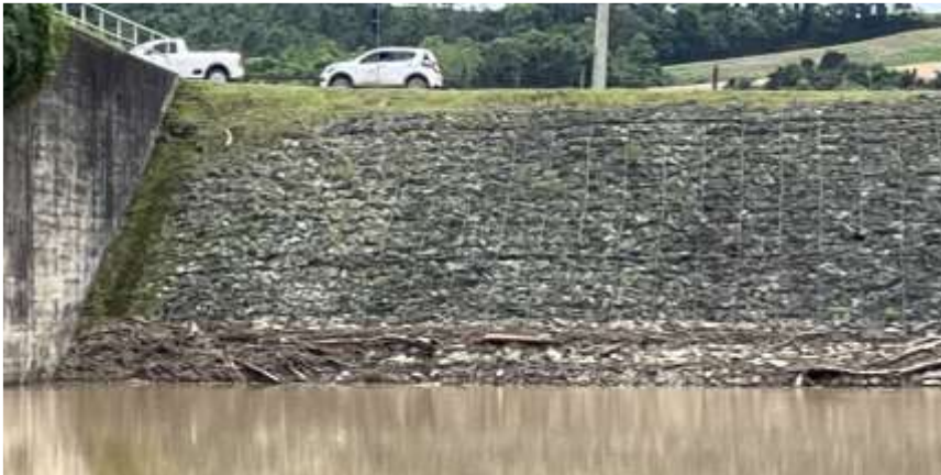
Foto N.º 30: Montante da barragem - Margem Direita Enrocamento de proteção do talude – Bom estado de conservação
