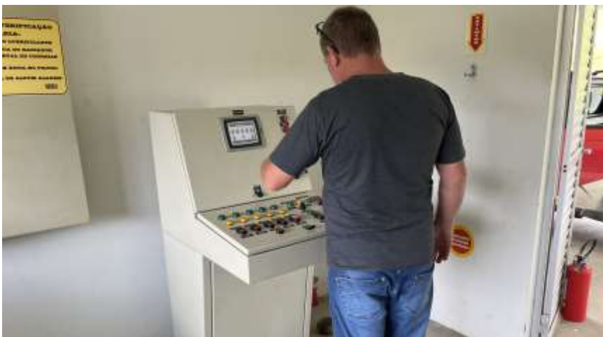
Foto N.º 01: Sala de Operação Operador em serviço
