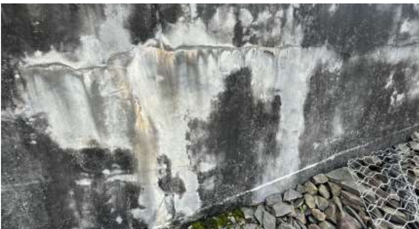
Foto N.º 25: Jusante da barragem - Vista lateral do Muro Presença de processo de carbonatação do concreto
