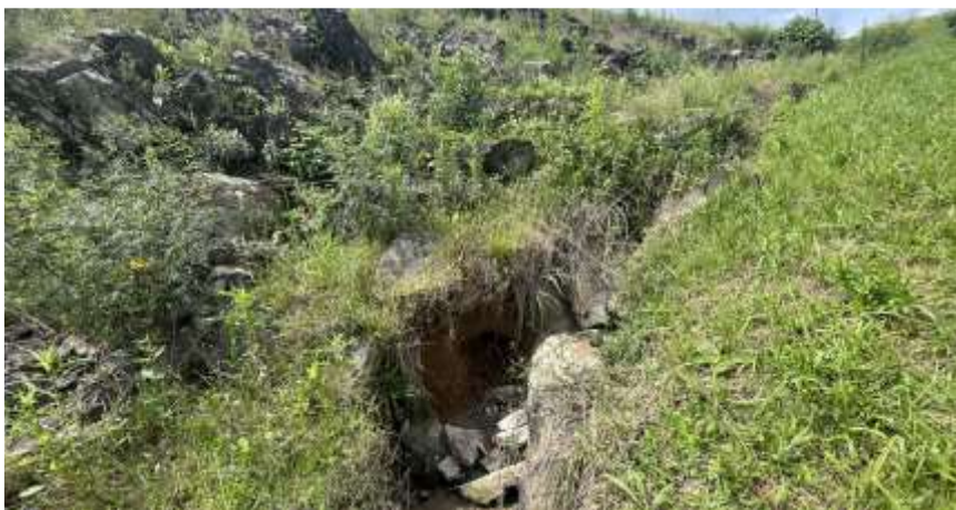
Foto N.º 11: Margem Esquerda - Jusante da barragem Valeta de escoamento de águas pluviais - Pequeno processo erosivo
