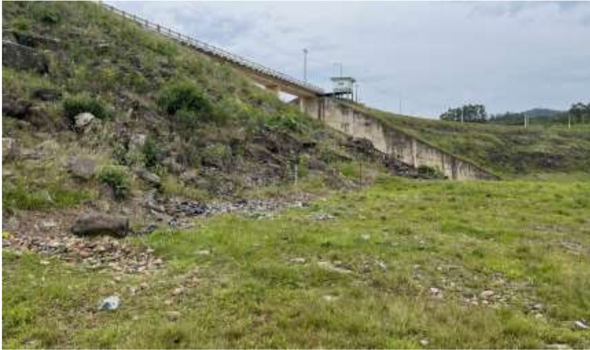
Foto N.º 36: Jusante da barragem - Margem Direita Talude de enrocamento e grama no pé da barragem
