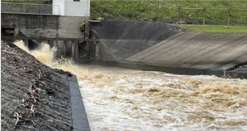
Foto N.º 18: Margem Esquerda - Jusante da barragem Operação de abertura de comportas hidráulicas
